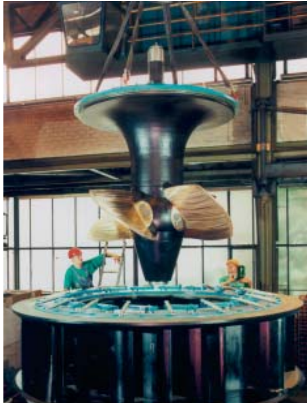
Compact Kaplan Turbine in der Werksmontage
