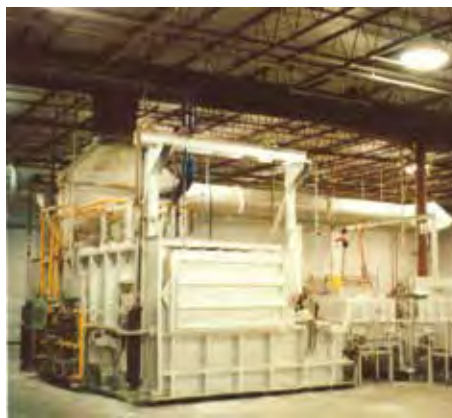
▲ Zu dieser HiTEQ Linie zum Schmelzen, zur Behandlung, Zuführung und zum Warmhalten von Aluminium gehören gasbefeuerte Badöfen und ein Schachtschmelzofen zum energieeffizienten Schmelzen von Rücklaufmaterial.
