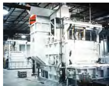
▲ Badofen mit speziell angeordnetem Brenner und einer Schmelzleistung von 1.200 kg/h
