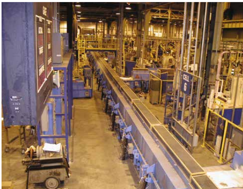
▲ 182 m langes, elektrisch beheiztes Rinnensystem mit 12 Stationen
