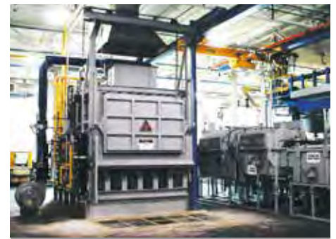
▲ Schmelzbadofen mit einer Kapazität von 1.800 kg/h
