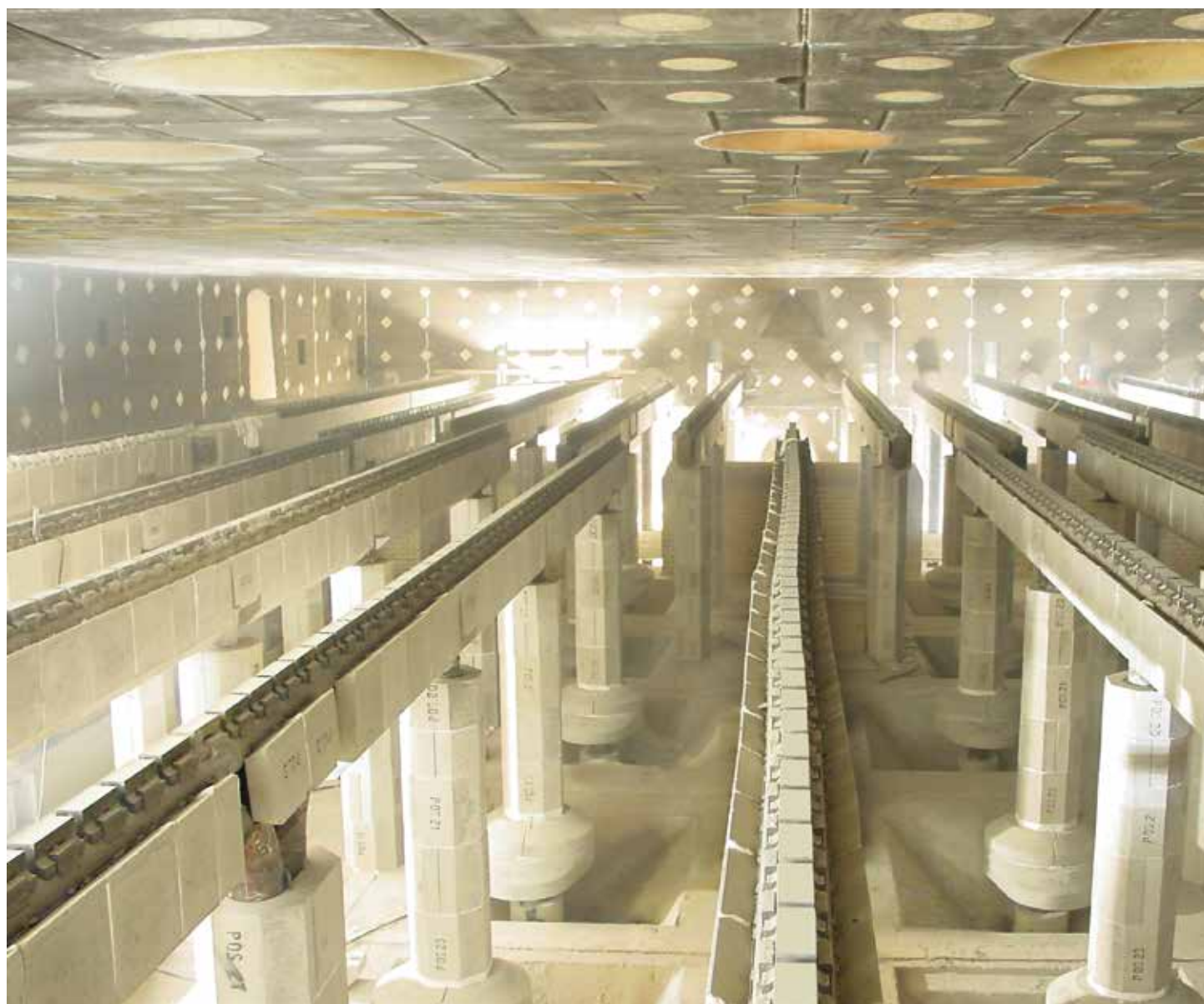
▲ 于步进炉滑块水冷管道的预制绝热外壳
