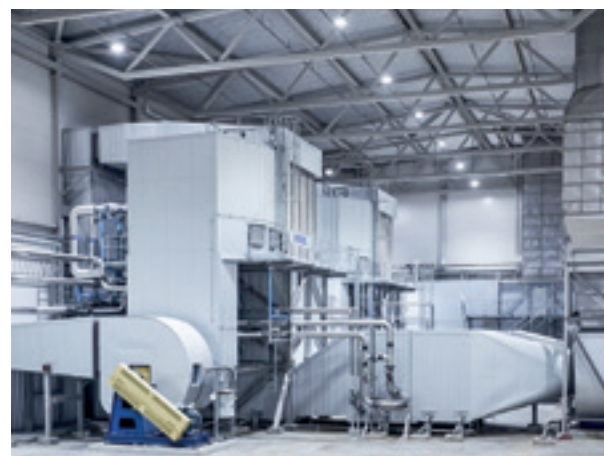
Детали системы утилизации тепла, расположенные в сушке целлюлозы
