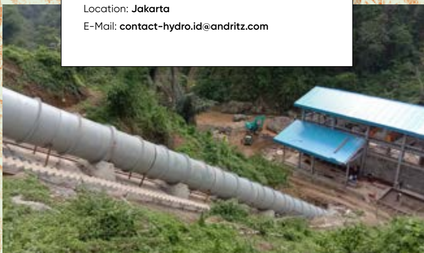
Penstock Cikaengan 2, West Jawa, 2 × 3.65 MW
