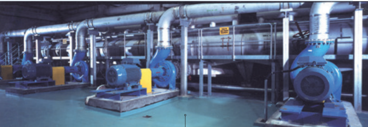
Andritz centrifugal pumps.
